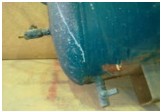
شکل ۷-۷- شیر تخلیه آب و روغن اضافی در زیر مخزن کمپرسور.
