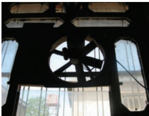
شکل ۳۸-۸- هواکش بزرگ در کارگاه.
