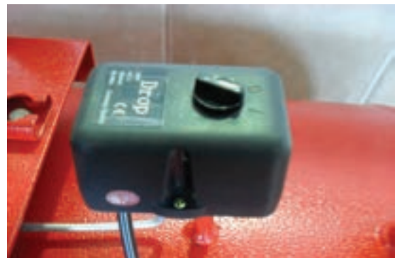
شکل ۹-۷- جعبه کلید قطع و وصل جریان برق.
